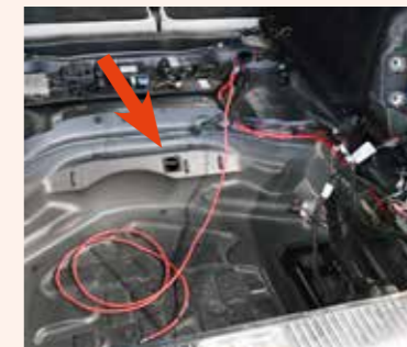
Schritt 1: Zunächst im Kofferraum ein Durchgangsloch von 40 mm bohren (Pfeil), um den Kabelbaum ins Fahrzeuginnere zu ziehen. Achtung: Aufpassen, dass sich hinter dem Blech kein Schlauch oder Kabel befindet.
